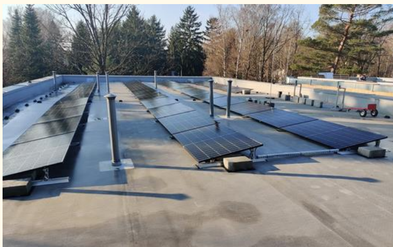
Rysunek 23. Instalacja fotowoltaiczna na budynku Przedszkola 83
