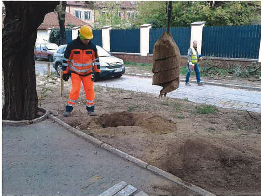
Ryc. 11 Punktowe fundamentowanie w systemie korzeniowym drzew (fot. Suchocka).
