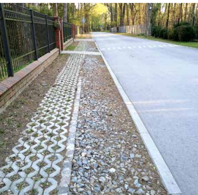
Fot. 12. ulica Cicha – pobocze retencyjne.
